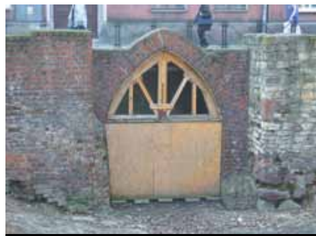
Wyremontowany skwer przy Placu Rzeźniczym szpeci płyta paździerzowa, zabezpieczająca wejście pod murami obronnymi.
